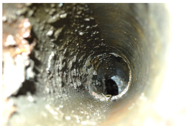
Ukázka drenážní trubky, které v současné době odvádějí vodu z mokřadu.
